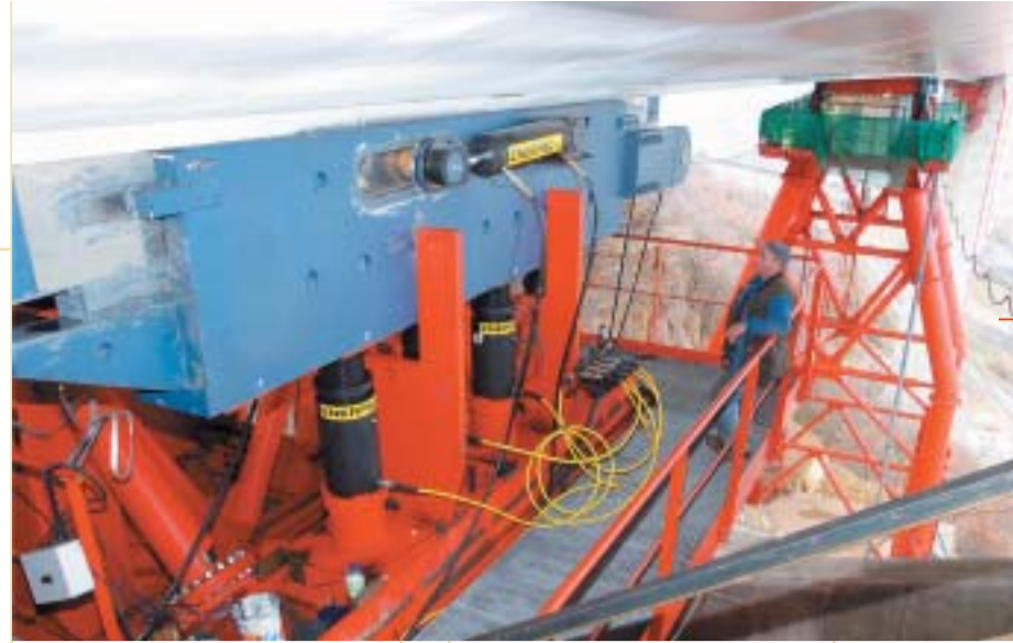
C'est grâce aux translateurs que les milliers de tonnes du tablier peuvent être soulevées et déplacées.
